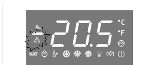
Ce LED indique un état d'ALARME / PANNE.
